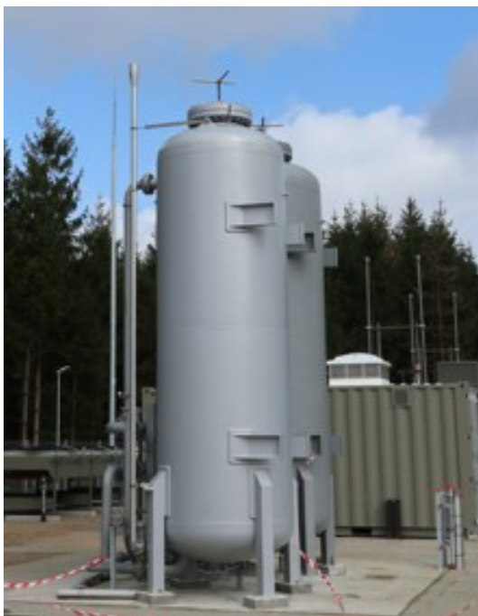
Foto nr. 03. Deodoriseringsanlæg.
